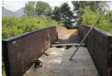
Il ponte ciclopedonale danneggiato durante le riparazioni
