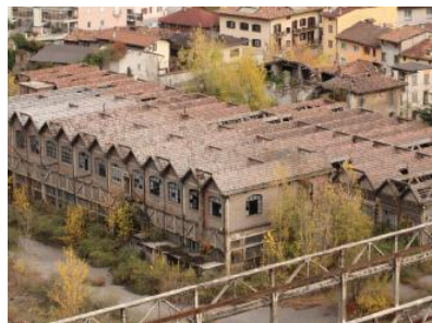
L'acciaieria abbandonata versa in condizioni di profondo degrado
