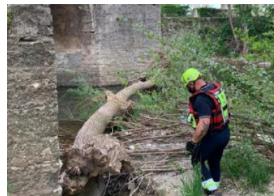
Uno dei tronchi che ostruiva il deflusso dell'acqua dell'alveo
