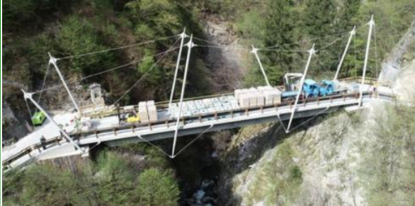
Le operazioni di collaudo del nuovo Ponte Lungo di Ceto riprese dall'alto
