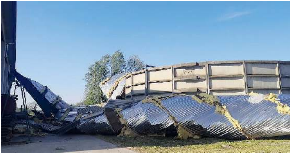
Accartocciato. Il tetto del capannone agricolo colpito dalla furia del vento
