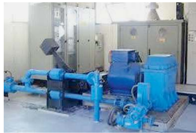
L'impianto. La centrale dell'acquedotto nella parte alta, vicino alle vasche
