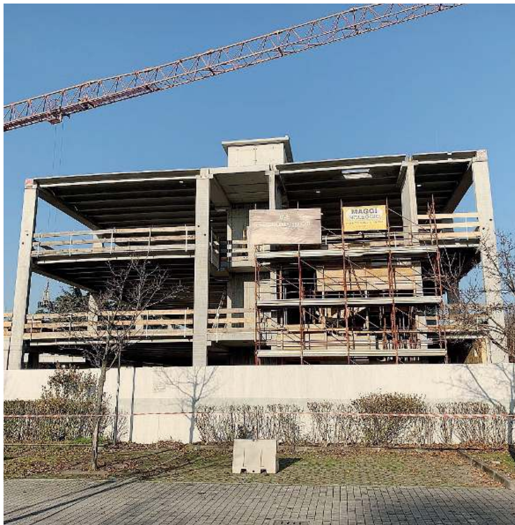
Si lavora. La nuova casa del Dormitorio sta crescendo in via Trivellini dietro l'Esselunga di via Milano
