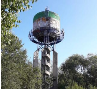
La torre di via Lizzere sarà sostituita con un impianto per l'acqua
