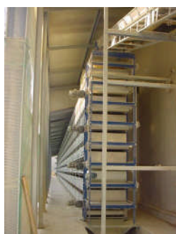
batterie con tunnel esterno
